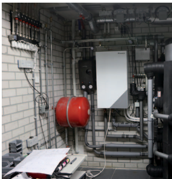
Een houtkachel geeft zijn warmte af aan een groot buffervat in de kelder.
